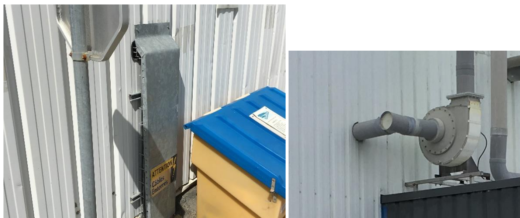
Figure n°2. Exemple de traversée de paroi occasionnant des fuites acoustiques
